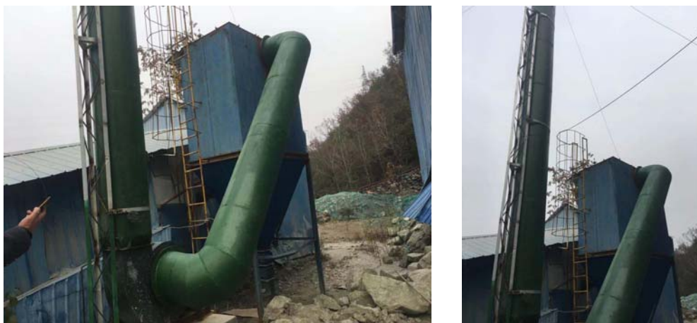
破碎车间配套除尘器及 15m 高排气筒
