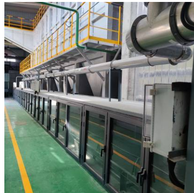
输送皮带机封闭及收尘管道
