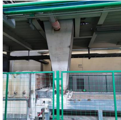
挥发炉封闭进料斗及收尘管道
