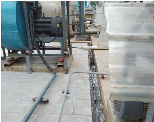
喷淋塔区排水槽
