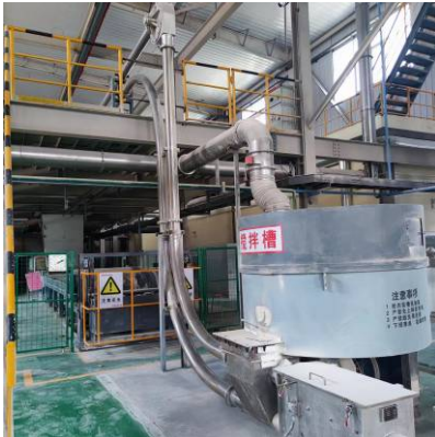
平口搅拌机废气收集管道
