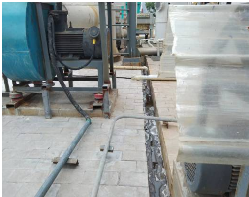
喷淋塔区排水渠
