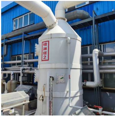
工艺废气碱液喷淋塔
