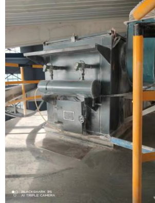
粗三氧化二砷筒仓仓顶除尘器及出气收集
