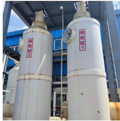
工艺废气除雾塔
