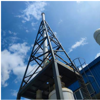
工艺废气排气筒 (DA025)
