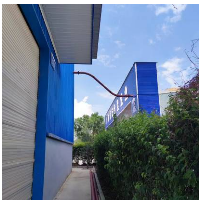
粗三氧化二砷输送管道
