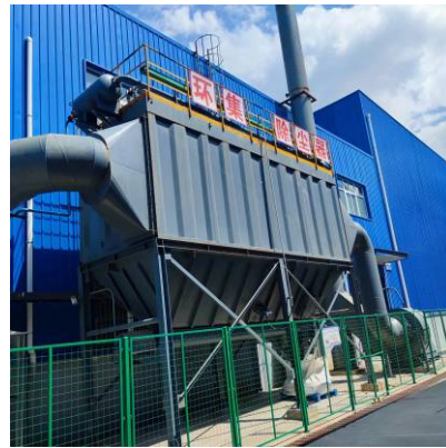
环集废气除尘器
