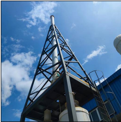
DA025 排气筒及监测平台
