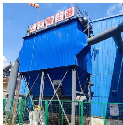
工艺废气除尘器
